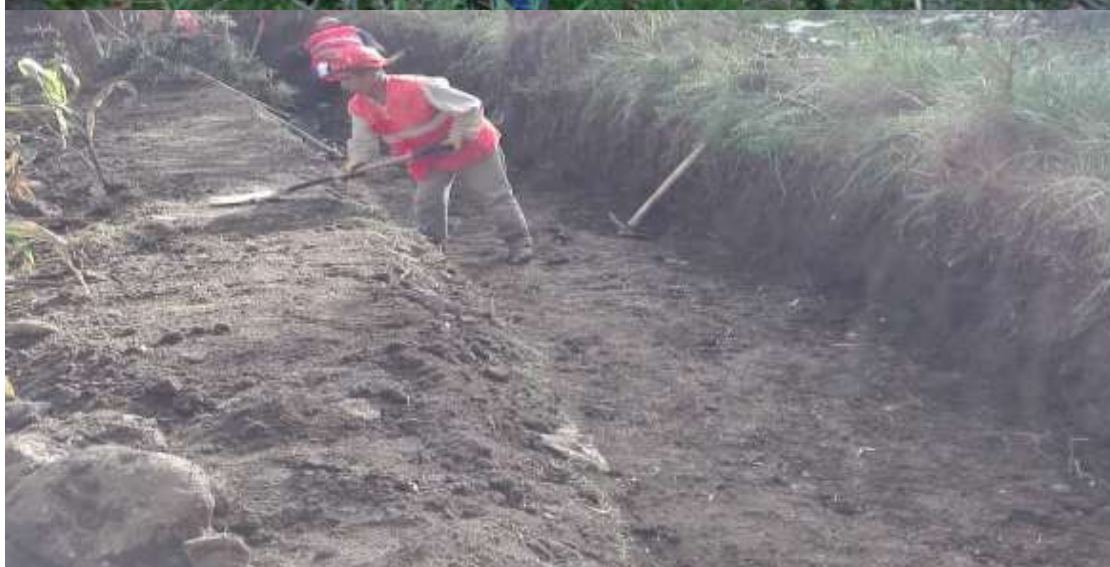
Entrega de terreno, charla de inducción en seguridad e inicio de los trabajos de limpieza y encausamiento de la quebrada “El Olivo”.
