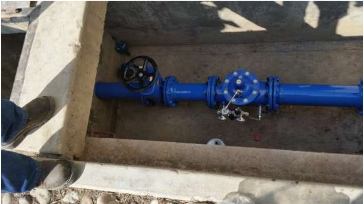
FOTO N° 10 REPOSICION DE LAS VALVULA BETA, REGULADORA DE PRESIONES DEL CANALITO GALLITO CIEGO
